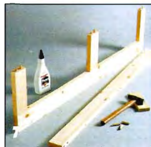
7 Три вертикальные обвязки сажают на горизонтальную с помощью молотка и деревянной подкладки. Клеем промазывают только гнезда под шканты.
